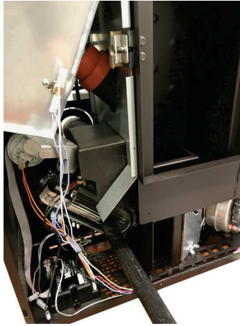
Fig. 93 - Room fan cleaning
