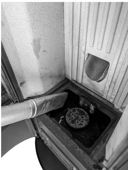
Fig. 39 - Rengöring av brännkoppfacket
