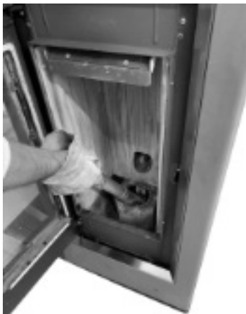
Fig. 35 - Rengöring av brännkoppfacket
