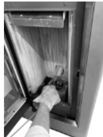
Fig. 36 - Rengöring med piprensare
