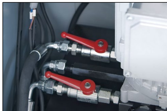
Bild: Kulventiler i nivelleringsläge
