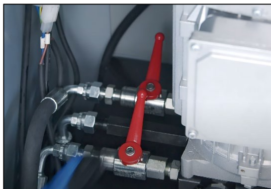
Bild: Kulventiler i driftläge
