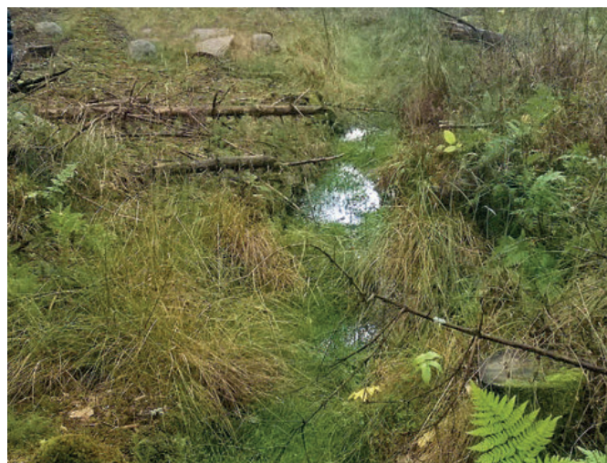
Rensat dike som redan efter några år börjat växa igen på grund av brist på beskuggande träd.
