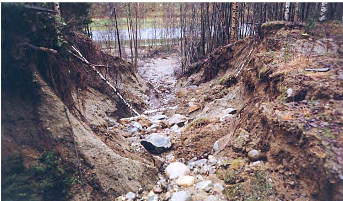
Tidigare traktorväg där spårbildning orsakat kanaliserade vattenflöden med efterföljande erosion.
