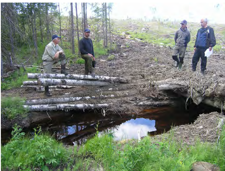
Trots att man byggt en bra bro har körningen medfört att slam transporterats ut i bäcken via körspåren. Det är viktigt att på- och avfarten till bron görs så att detta inte kan ske. Det kan till exempel göras genom risning eller kavling. Foto: Per Simonsson
