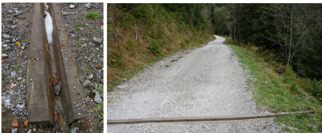
Figur 31. Öppna tvärdiken i Österrike. Anläggs då vägen lutar och risk finns att vattnet får så hög fart att det kan erodera vägbanan. Med hjälp av öppna tvärdiken fångar man upp vattnet från vägbanan och fördelar det ut i terrängen eller leder det till mer stabila områden. Foto: K. Lundström och A. Lomander
