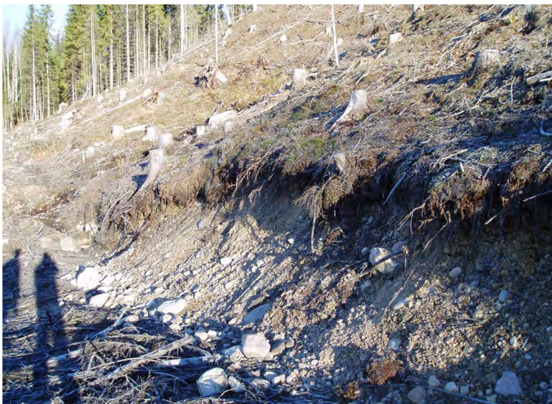
Figur 57. Erosion av vägslänter inom branta områden är en indikation på att det kan finnas risk för erosion och ras. Foto: K. Lundström
