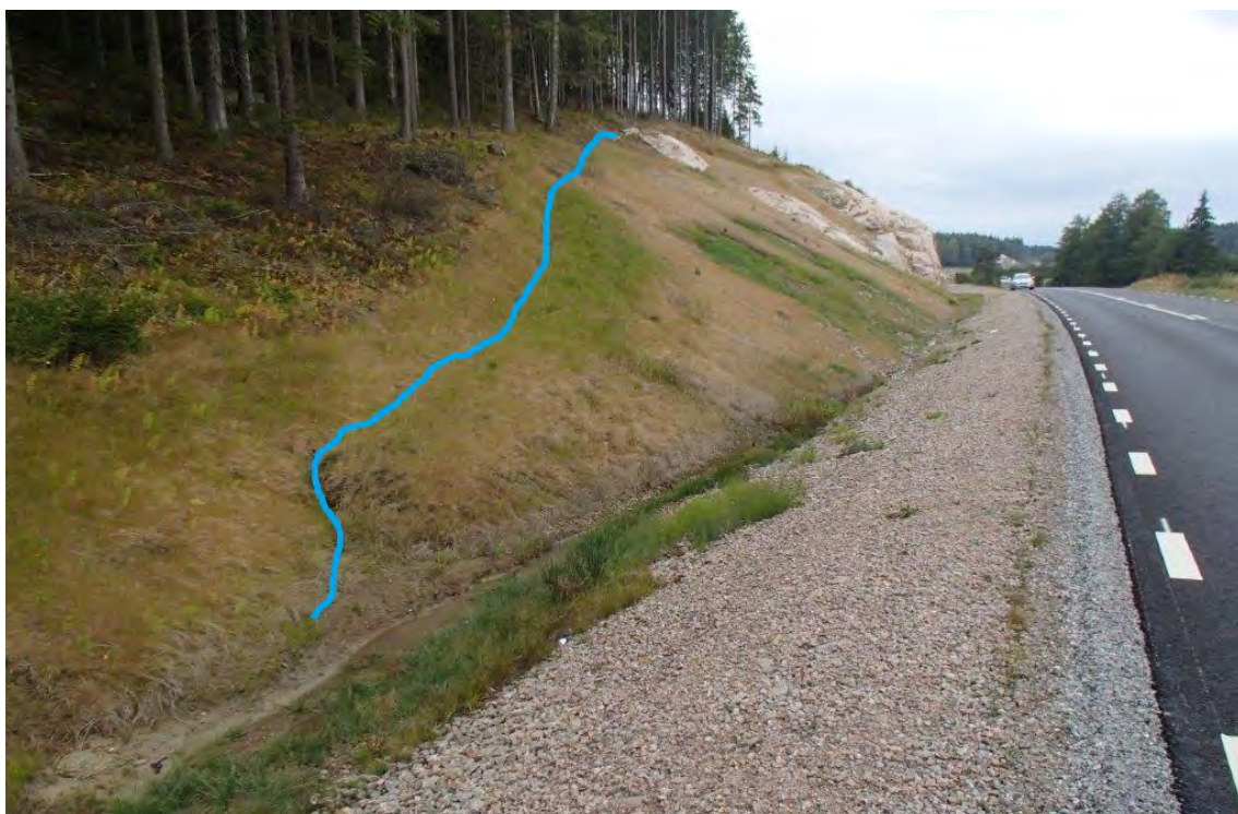
Figur 26. Överdiken, markerad med blå linje, ovanför vägskäringen fångar upp och avleder vatten som annars skulle kunnat infiltrera i väggroppen och få den att rasa. Foto: A. Gunnarsson
