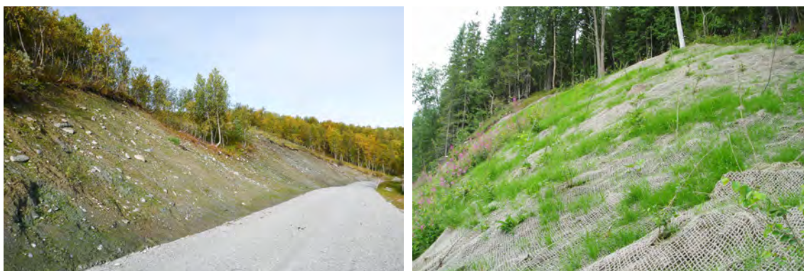
Figur 14. Det vänsta fotot visar erosion av en nyanlagd skärningslänt mot ett vägdike inom ett brant område med ett högt innehåll av silt. Det högra fotot visar en väglänt där kokosnät kombinerat med sådd av gräs används för att stabilisera och förhindra erosion. Foton: K. Lundström
