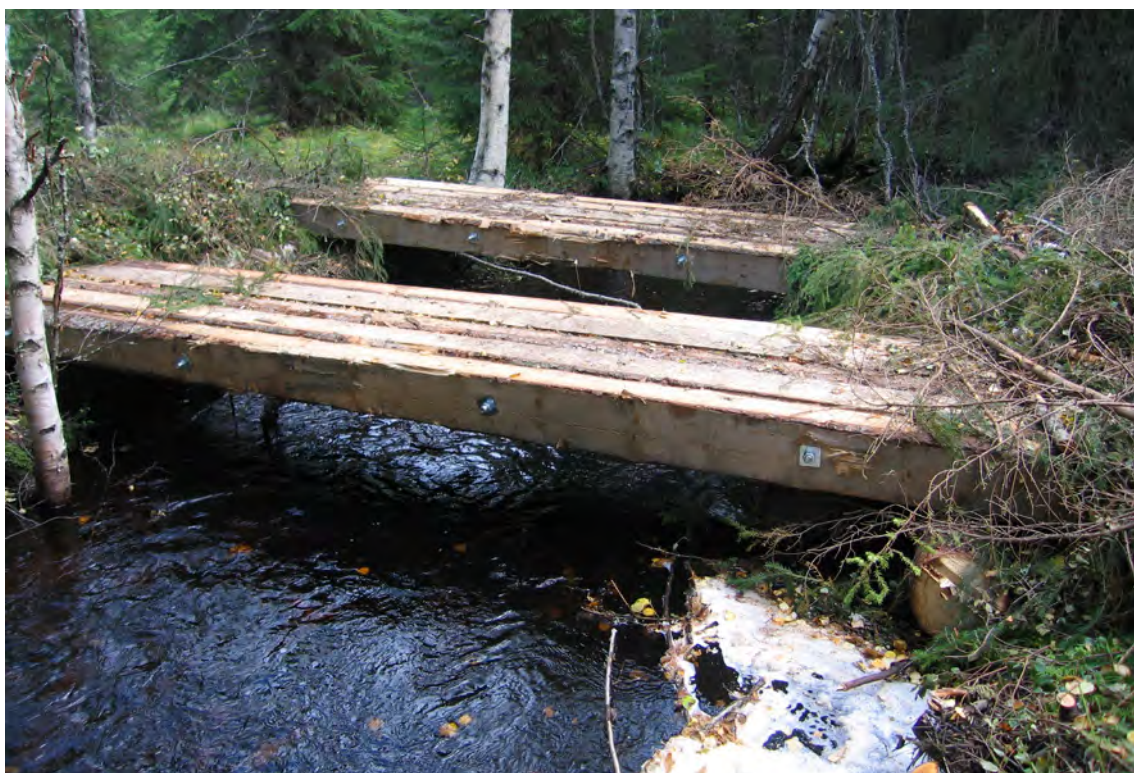
Figur 46. Tillfällig bro byggd med markskonare. Kanterna på vattendraget är stabiliserade med tvärgående stockar, som förhindrar markskonarna att tryckas ned i marken. På- och avfarterna är förstärkta med ris och grova toppar. Foto: A. Lomander
