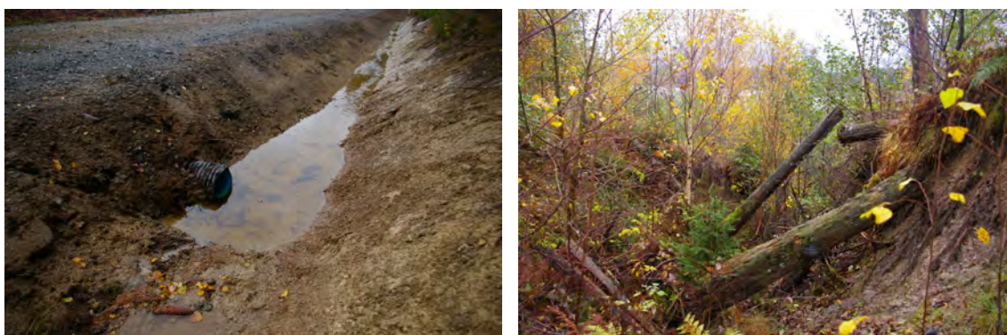
Figur 33. Ravinbildning orsakad av ett koncentrerat flöde i en underdimensionerad vägtrumma. Ravinbildningen startade våren 2007 i samband med anläggande av en skogbilväg inför en avverkning i Bohuslän, och rasen fortgår fortfarande 2016. Idag är ravinen över 100 meter lång och 3–4 meter djup. Foton: A. Lomander
