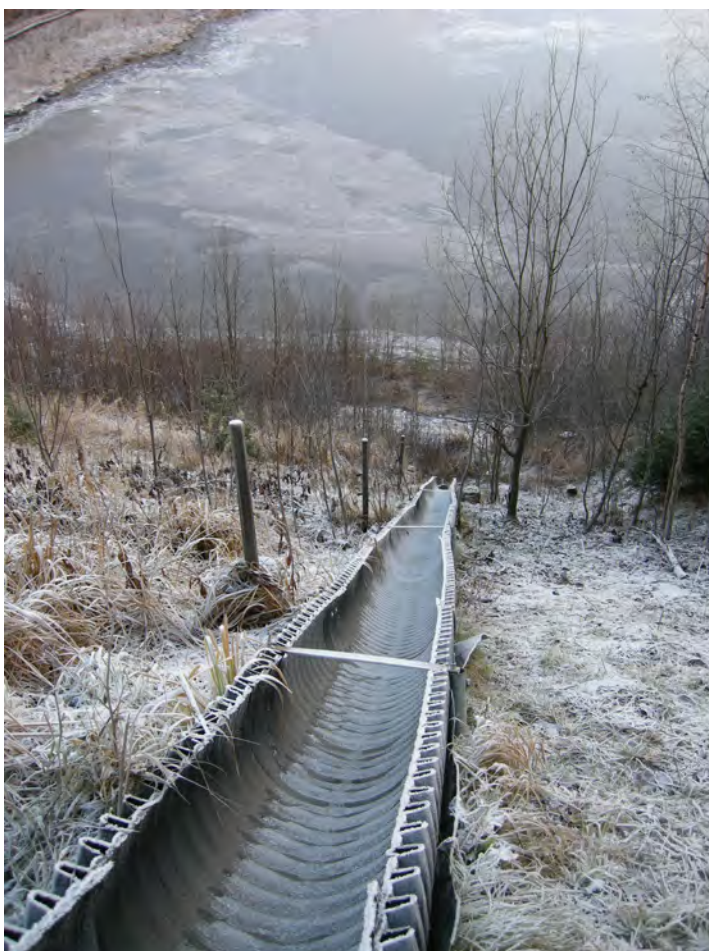
Figur 51. Ett exempel från Näsåker där vatten från uppströmssidan av vägen leds först i trumma under vägen och sedan i denna öppna trumma nedför den känsliga sluttningen. Foto: K. Lundström
