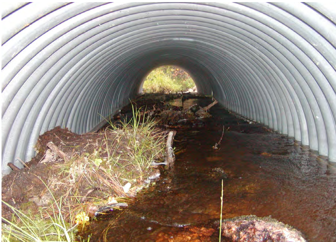
Figur 53. En anlagd valvtrumma som börjat att fyllas av material som eroderat från vägbanken och spolats in i trumman. Om inte detta rensas bort och inloppet till trumman erosionsssäkras finns risk finns att proppen byggs på och trumman sätts igen. Effekten kan bli översvämning med erosion och ras av vägbank eller kringliggande mark som följd. Foto: P. Hallgren
