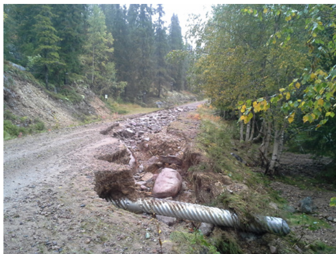
Figur 13. Erosion och bortspolad trumma vid regnoväder september 2015.
